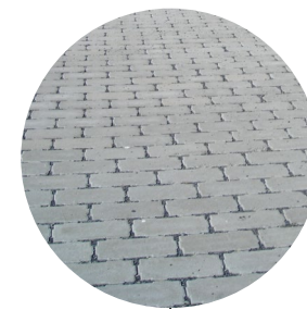
woonerf waterpasserende straatstenen
