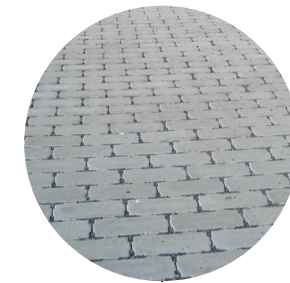
woonerf waterpasserende straatstenen
